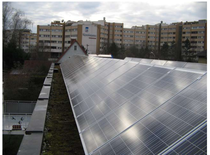
PV Anlage, im Hintergrund thermische Solaranlage
