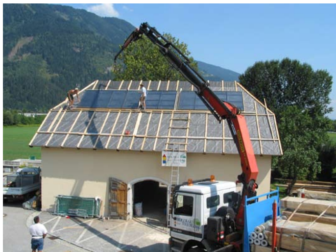
Abbildung 3.2.33: Montage Selbstbaukollektor St. Ruprecht
